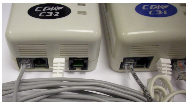
Рисунок 17. Система автономного контроля загазованности СГК-2. Вид на разъемы линии связи сигнализаторов загазованности (кабель подключен).
